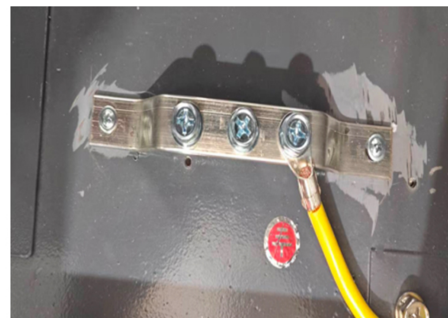
地线接线位置
